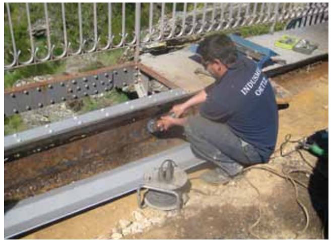
Fig. 16. Limpieza de la corrosión y colocación de la chapa de refuerzo sobre la cabeza de la viga
